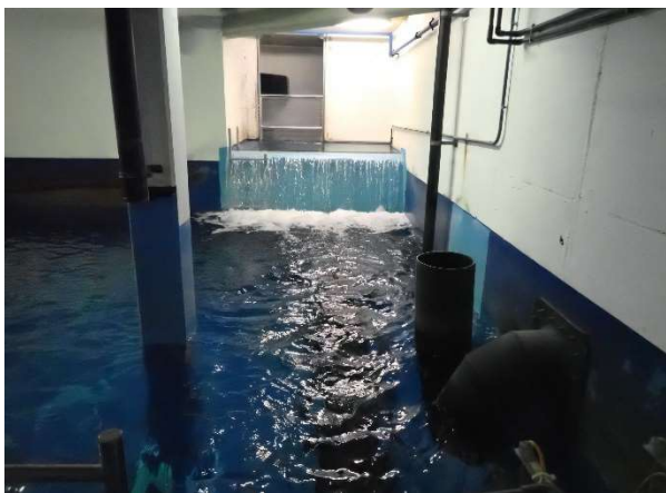
Abb. 31: Ausgleichsbecken mit Chemikalienzudosierung: Bei den Inspektionen wird nicht nur die Badewasserqualität, sondern auch die technische Ausrüstung der Aufbereitungsanlagen beurteilt.
