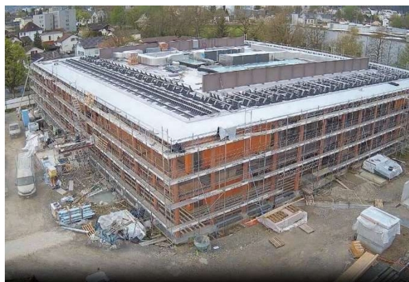
Abb. 14: Ansicht des Neubaus vom benachbarten Gebäude der Bauschule. Der Rohbau in Unterentfelden steht.
