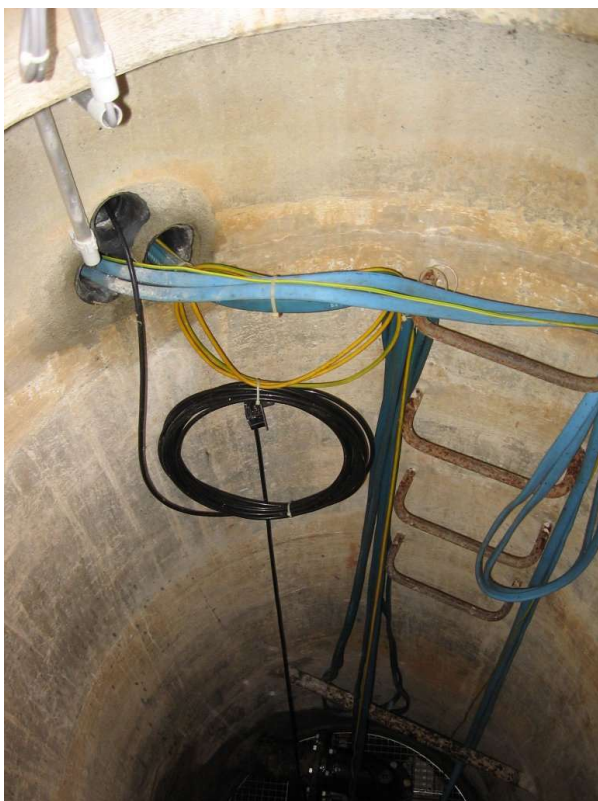
Abb. 29: Fehlende Abdichtungen bei Kabeldurchführungen werden bemängelt, wenn Schmutzwasser, Insekten oder Nager auf diesem Weg in den Fassungsschacht gelangen könnten.
